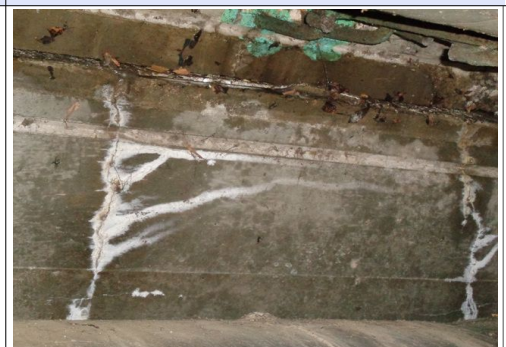
슬래브하면 캔틸레버 균열부백태 (S9)
